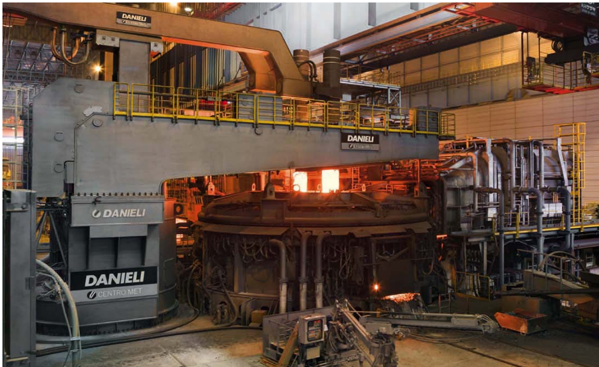
Рис. 14.12. Сталеплавильная печь постоянного тока на 420 тонн, построенная японской фирмой "Japan Steel"
